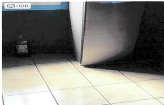
Foto 2: Cambio de piso cerámico en cocina y remplazo de ventana tipo pvc ..
